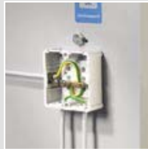
Anschlusskasten für Potenzial-Ausgleichleitungen
